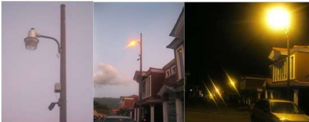
Figura No. 34 Lámparas de sodio con luminaria tipo canasta utilizada en el alumbrado público.
