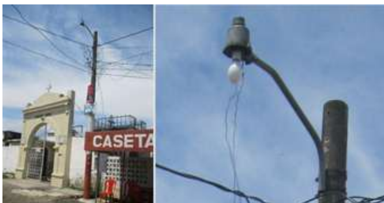
Figura No. 41 Luminarias y lámparas dañadas.
