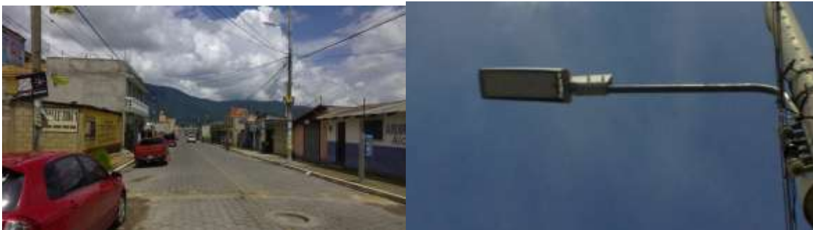
Figura No. 30 Lámpara led tipo cobra colocadas en municipio de La Esperanza, departamento de Quetzaltenango.
