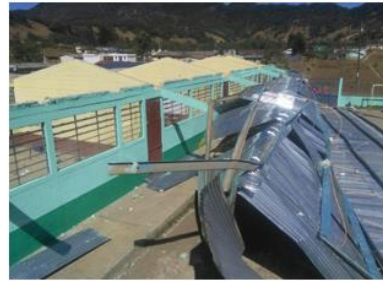
b) Daño por viento en escuela. Fuente: prensalibre.com
