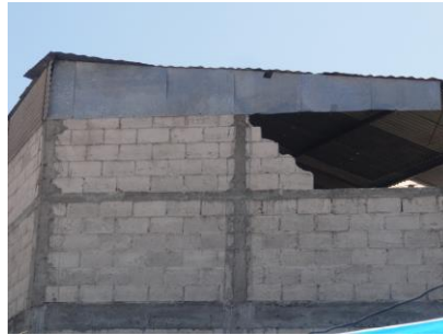
Figura 28. Daño por sismo, falla fuera de plano en estructura tipo cajón de mampostería con techo liviano flexible.
