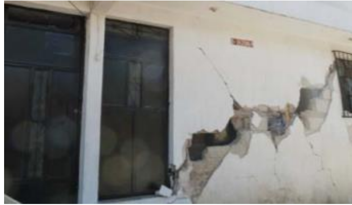
Figura 3. Daño estructural, Terremoto San Marcos 2012
